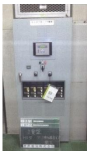
き電盤交換前
