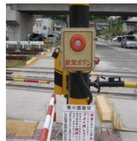
踏切支障報知装置
