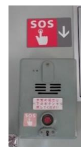
非常通報装置 1
