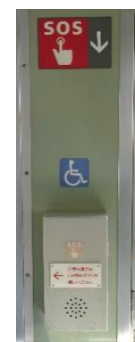
非常通報装置 2
