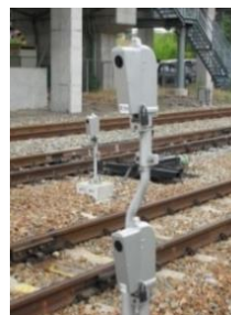
踏切障害物検知装置
