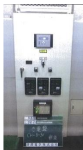
き電盤交換後
